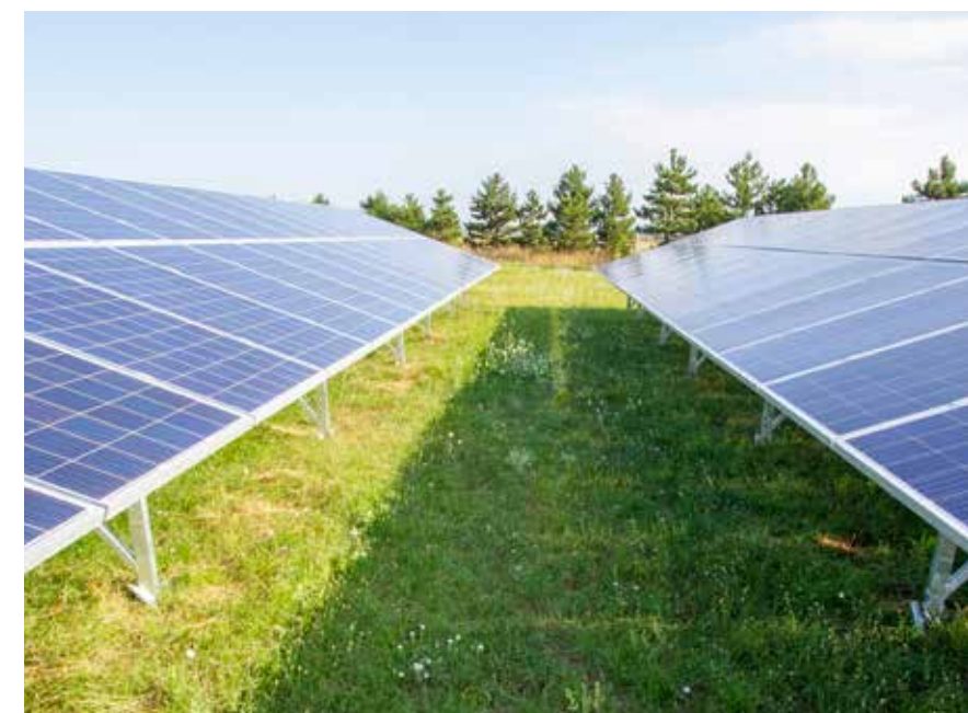
Abb. 63: Photovoltaikanlage beim Wasserwerk Ost
